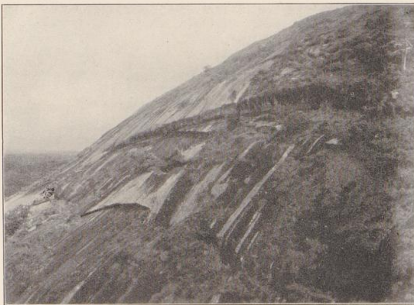
2. Schuppenartig abspringendes Gestein am Fui
