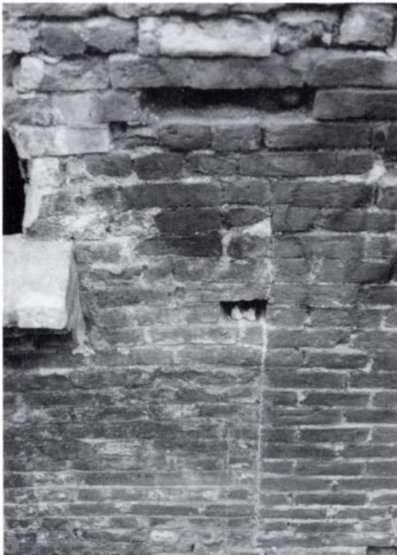
Abb. 4b: Sandstraße 3. Baufuge im Keller- mauerwerk, 1580 und älter.
