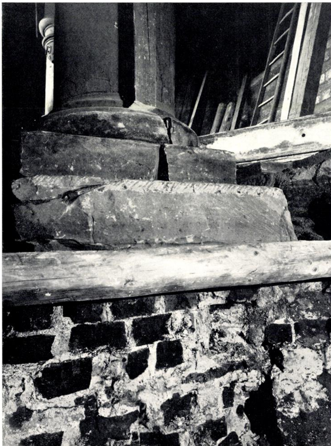
Querschnitt der baulichen Anordnung nach Eindringen in das Fundament: Unten der oberste Teil der drei Meter hohen Backsteinmauer, auf ihr ruhend der Unterlag-Block und auf ihm die Säulenbasis; weiter nach oben der untere Teil des Säulenschaftes (zu S. 129).
