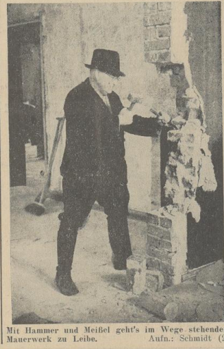
Mit Hammer und Meißel geht's im Wege stehendem Mauerwerk zu Leibe. Aufn.: Schmidt (2)
