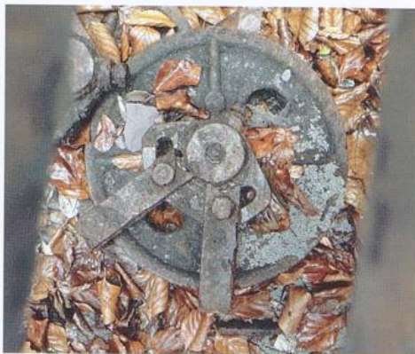
Bahnhof Bremen-Blumenthal, Umlenkrolle des mechanischen Stellwerks, 2022
