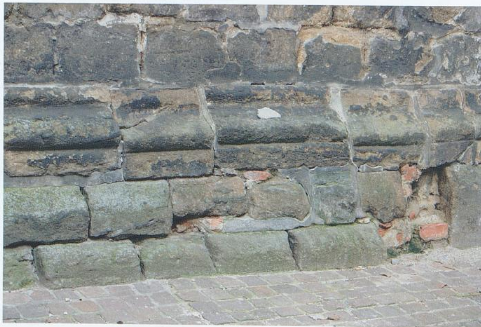
Schäden im Sockelbereich
