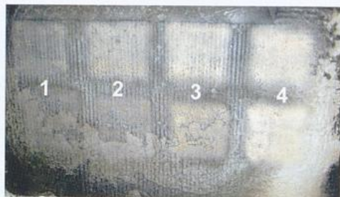
Dom, geschädigter Sandstein, Testflächen der Materialprüfungsanstalt
