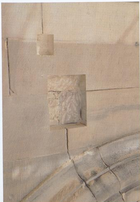
Geschädigte Sandsteinpartie, Vorbereitung für zwei Vierungen
