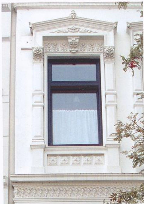
Negatives Beispiel einer Fenstererneuerung
