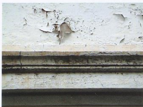
Typische Schadensbilder bei ungeeigneten Anstrichsystemen
