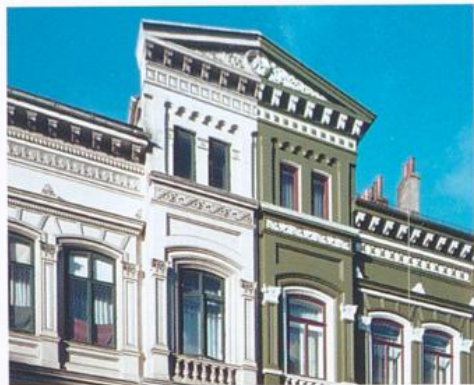
Störung der einheitlichen Fassadenwirkung durch unterschiedliche Farbgebung
