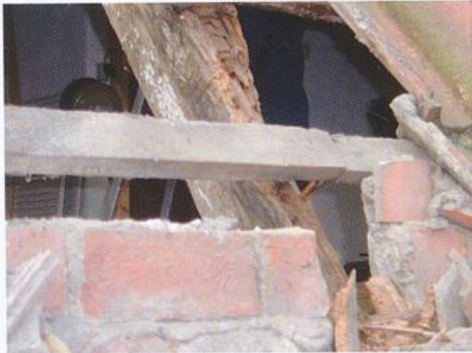
Schäden an der Dachkonstruktion
